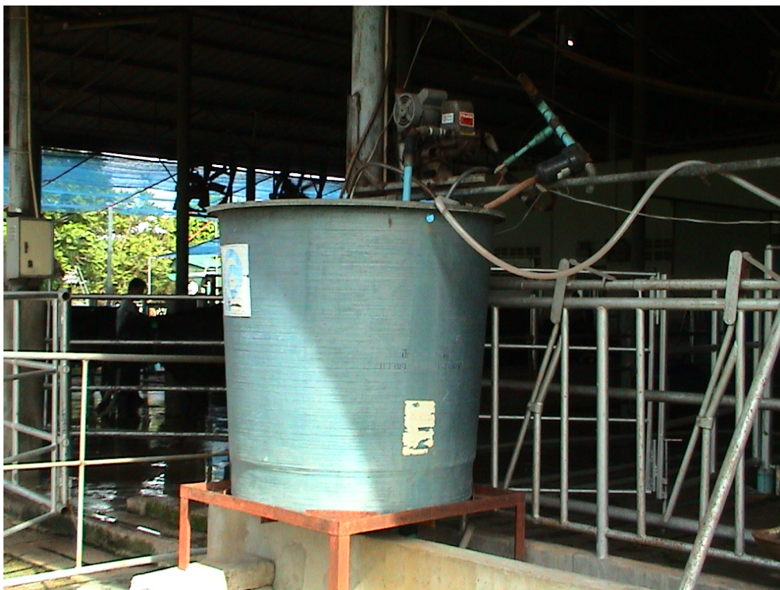
รูปภาคผนวกที่ 9 ถังบรรจุน้ำขนาดบรรจุ 1,000 ลิตร เพื่อสำรองน้ำ และมอเตอร์ขนาด 1 แรงม้า เพื่อฉีดพ่นน้ำเข้าใส่ cooling pad ทุกๆ 10 นาที โดยแต่ละครั้งฉีดพ่นนาน 3 นาที
